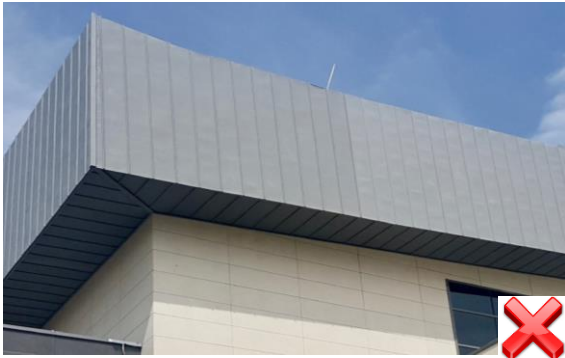
Aynı cephede "farklı" lot'lardan üretim yapılmış paneller
