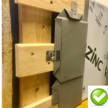
Örtü, havalandırma kesitini engellemiyor.
