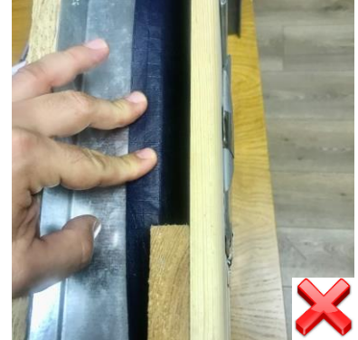
Örtü, havalandırma kesitini engelliyor.
