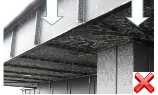
Yağmur suyu ile yıkanamayan ters tavan örneği
